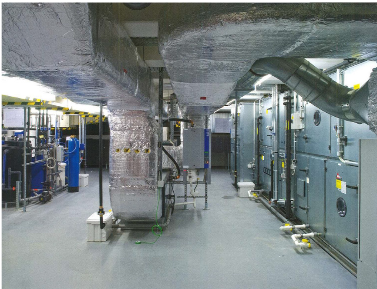
Centrála klimatizačního systému pro nový DB v jeho prvním podzemním podlaží.
