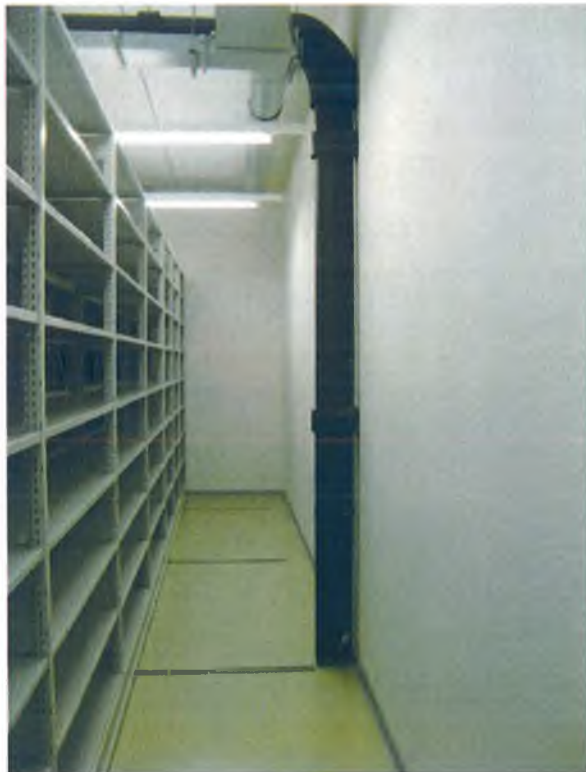
Abb. 5: Kompromisse der Adaption: Abwasserleitung im neuen Magazin.
