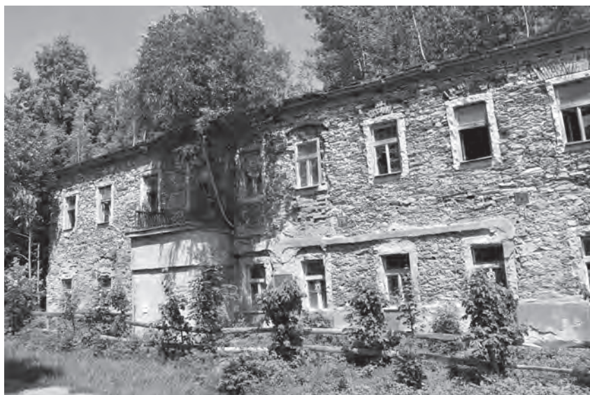
Obr. 7. Jesenný (okr. Semily), kdysi půvabná zámecká stavba se vlivem neprovádění údržby změnila ve zříceninu. Stav 11. července 2021 (foto autor)
